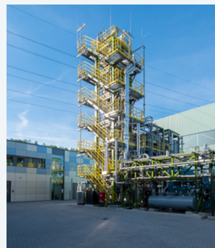
Carbon2Chem®-Technikum Foto: thyssenkrupp Steel Europe
