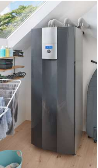
◀ Diese Sole-Wasser-Wärmepumpen mit Propan erfordern kein zusätzliches Lüftungskonzept. Foto: ait-deutschland
